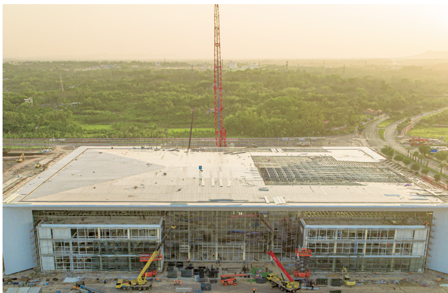
2月23日,在乐城先行区内,国际创新药械交流转换中心项目正在加快施工进度。袁琛/摄
