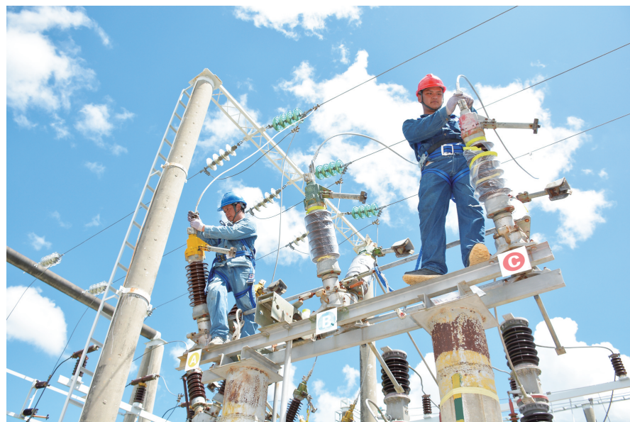
三亚供电局工作人员顶着烈日开展设备检修,确保崖州湾电力供应。刘昌/摄
